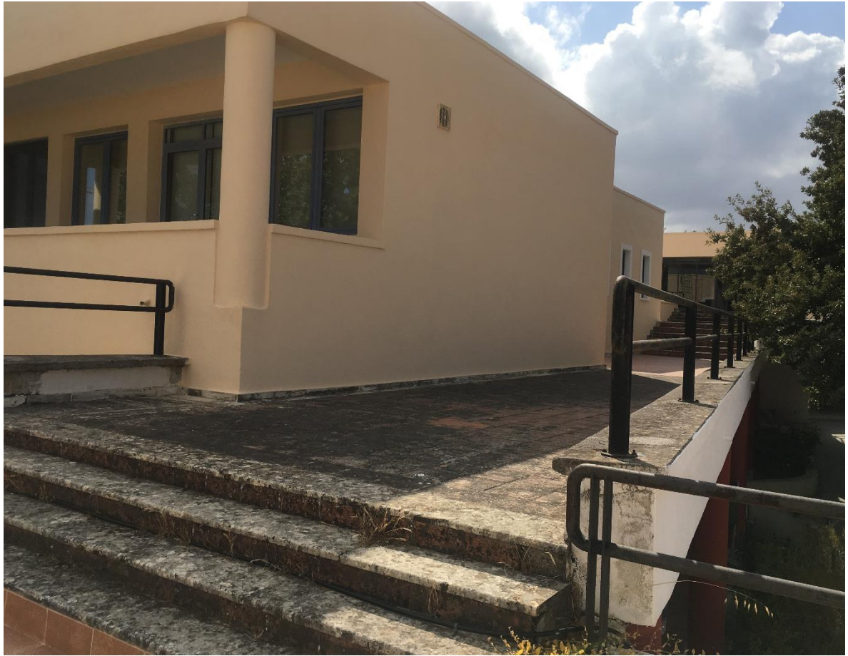
Εικόνα 3_ Υφιστάμενη κατάσταση πλακιδίων Πεζογεφυρών
