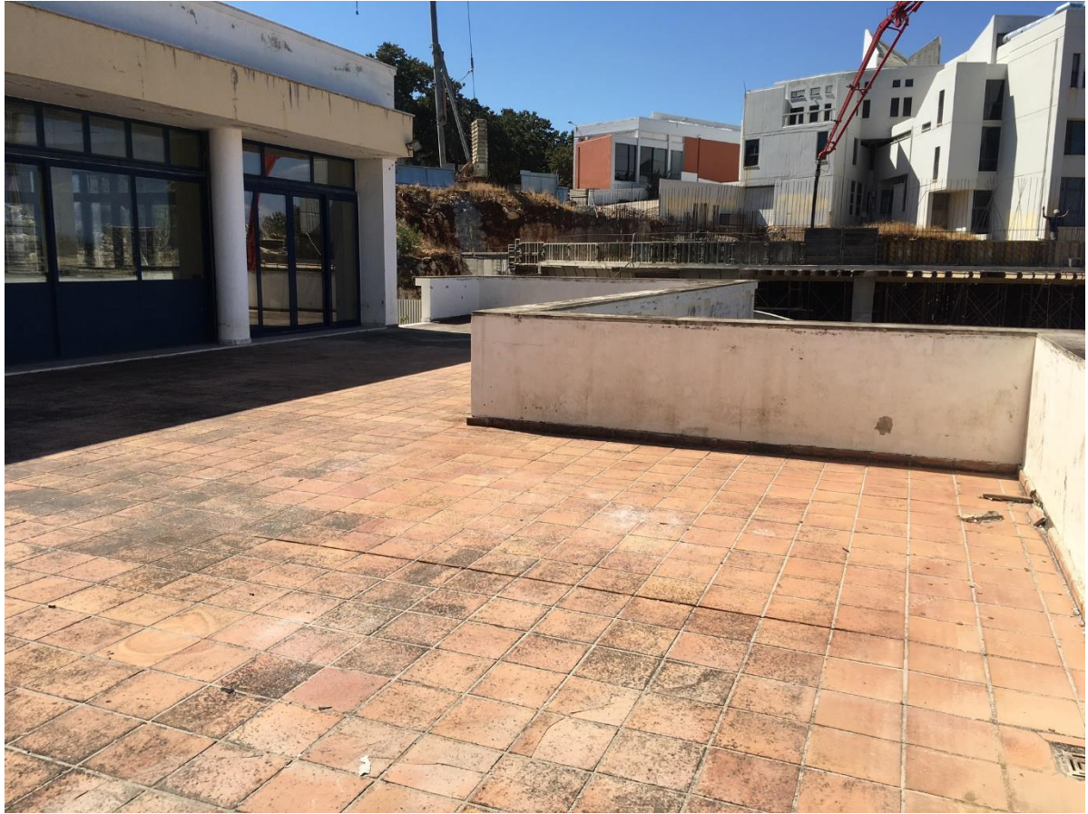
Εικόνα 1_ Υφιστάμενη κατάσταση πλακιδίων Εστιατορίου
