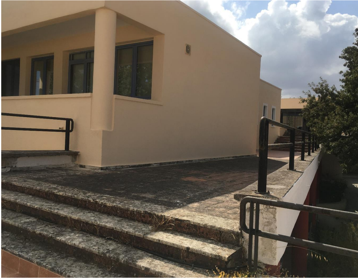
Εικόνα 4_ Υφιστάμενη κατάσταση πλακιδίων Πεζογεφυρών Α2
