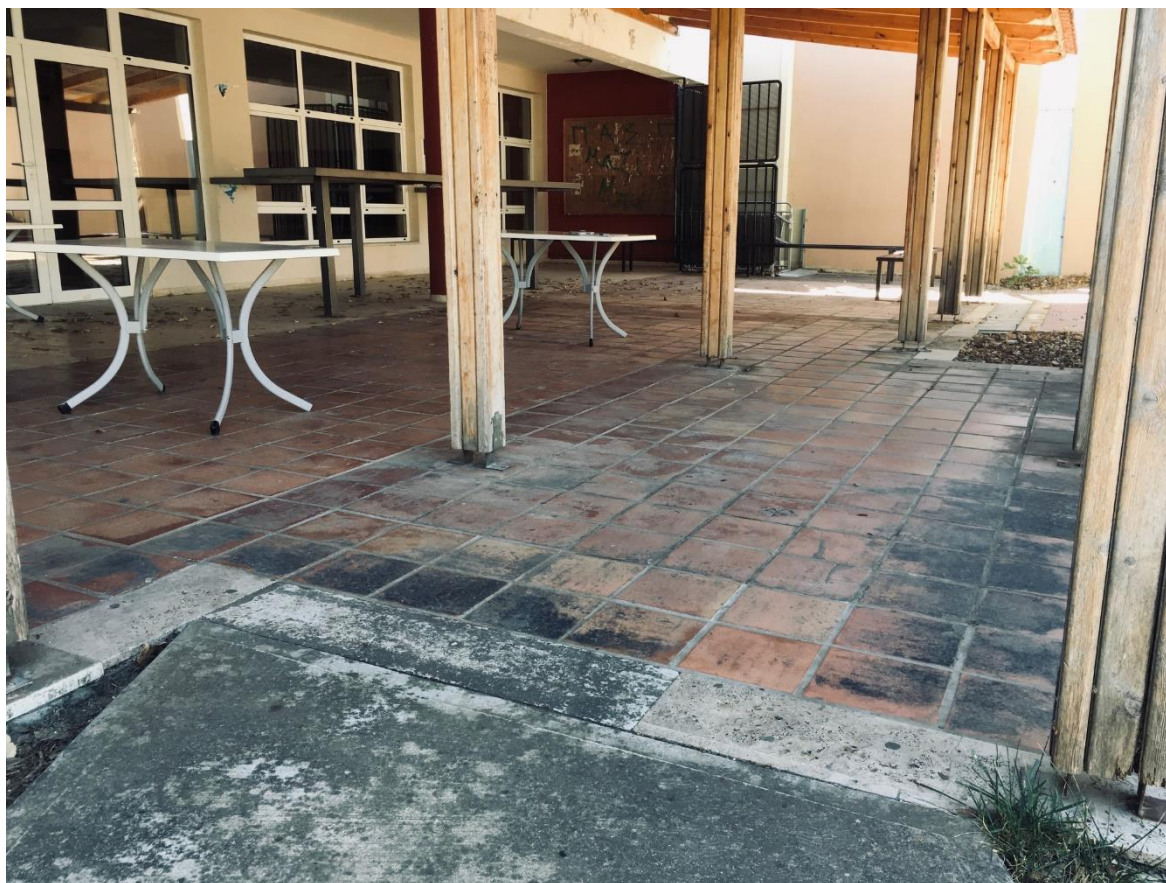
Εικόνα 2_ Υφιστάμενη κατάσταση πλακιδίων Κυλικείου
