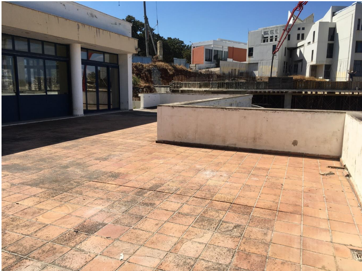
Εικόνα 1_ Υφιστάμενη κατάσταση πλακιδίων βόρειας βεράντας Εστιατορίου
