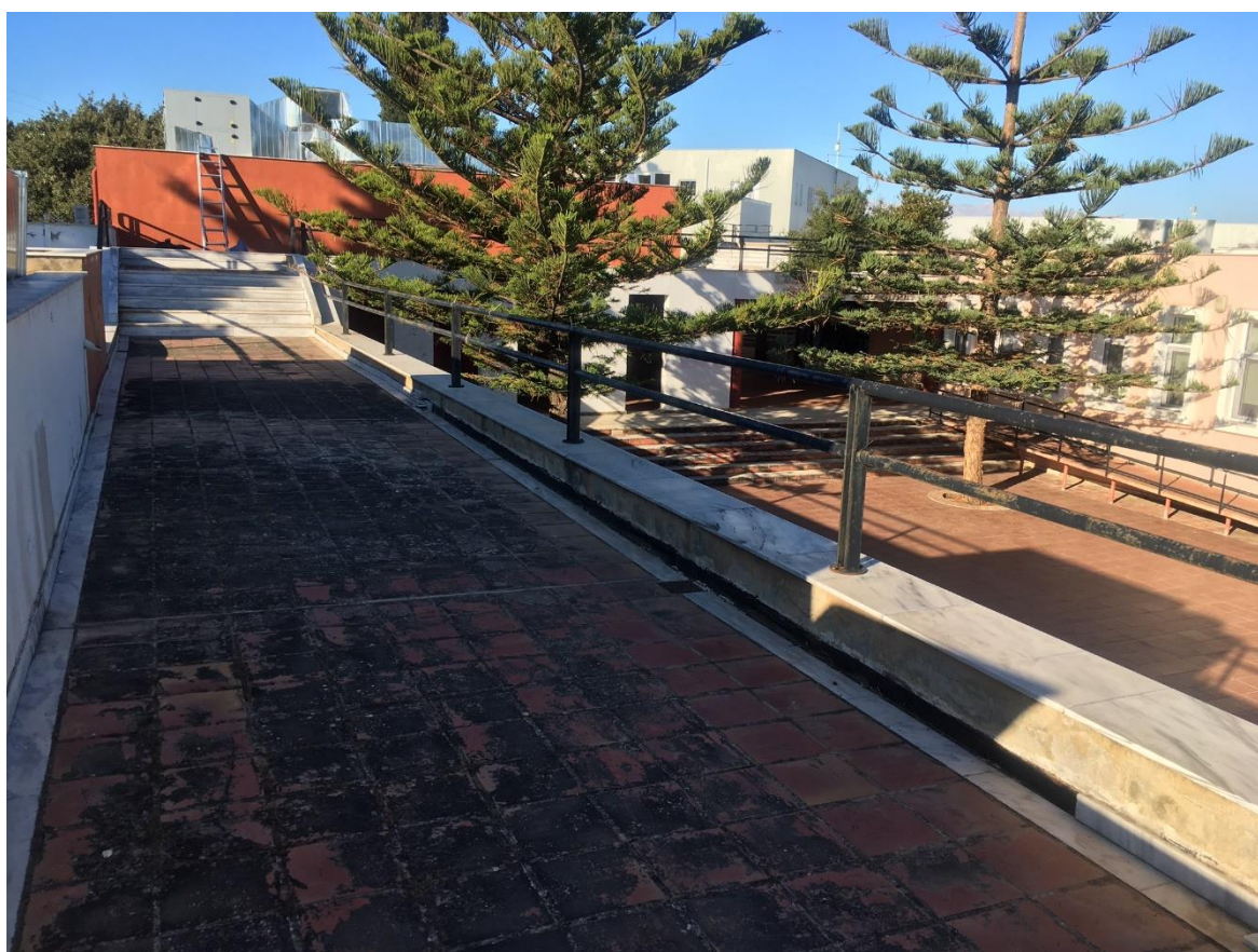
Εικόνα 3_ Υφιστάμενη κατάσταση πλακιδίων Πεζογεφυρών Δ-Γ
