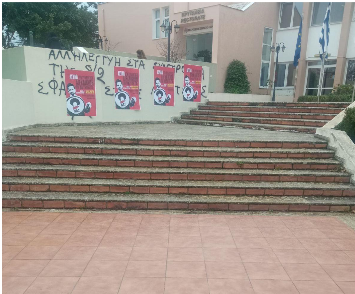
Εικόνα 8_ Υφιστάμενη κατάσταση ριχτιών Εισόδου Πρυτανείας
