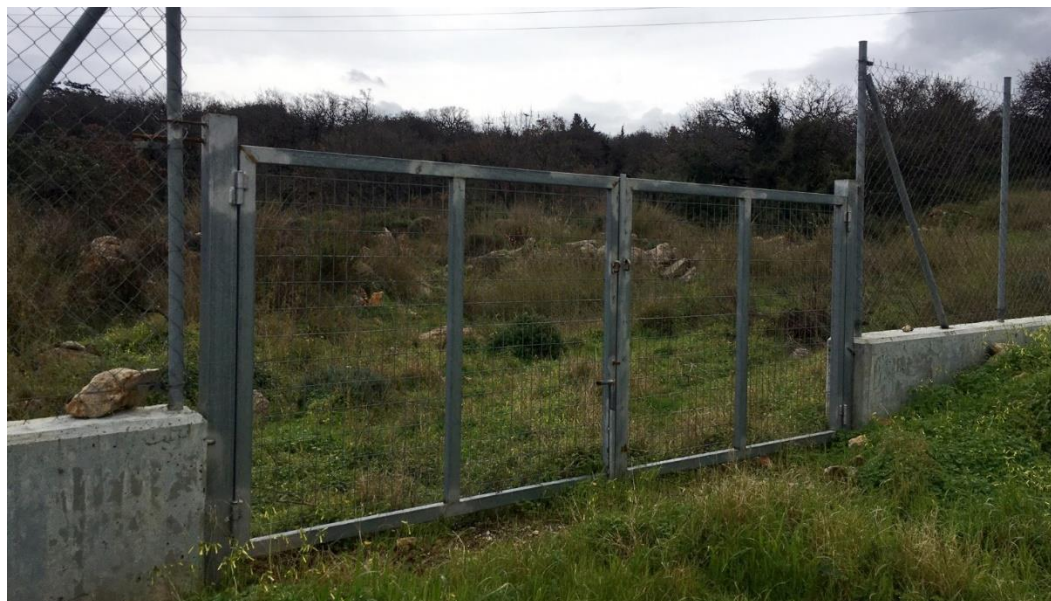
Εικόνα 2_ Υφιστάμενη μεταλλική σταθερή πόρτα (ανατολική είσοδος ΚΕΜΕ)
