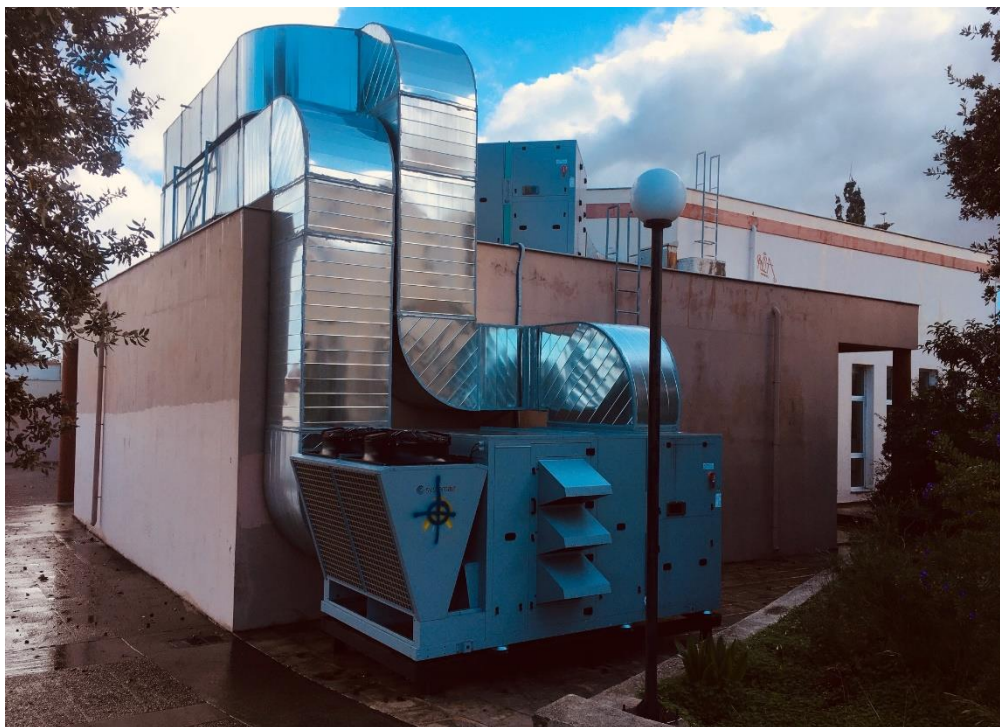
Εικόνα 1_ Υφιστάμενη εγκατάσταση εξωτερικής μονάδας (εξωτερικά Αμφιθεάτρου Δ3)
